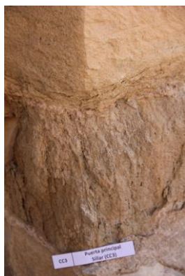
Fig. 9. Muestra CCPA03: sillar muy erosionado situado en la parte baja izquierda de la cara externa de la puerta principal del Castell de Castalla.
