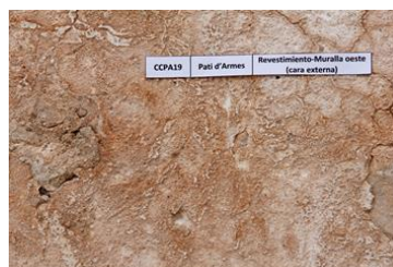
Fig. 10- Muestra CCPA19: revestimiento de la muestra CCPA20 afectado por grietas debido a diferencias de dilatación con la capa subyacente.
