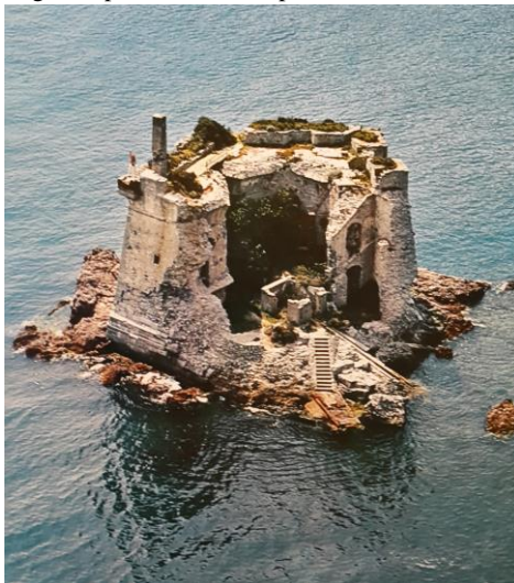
Figura 3 – Vista d'insieme di Torre Scola prima dei restauri. (da Marmorì F., op cit. , 1973, pp. 667)
