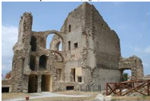
Fig. 6 - Il degrado della struttura
